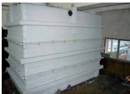
●FRP製薬品タンク
