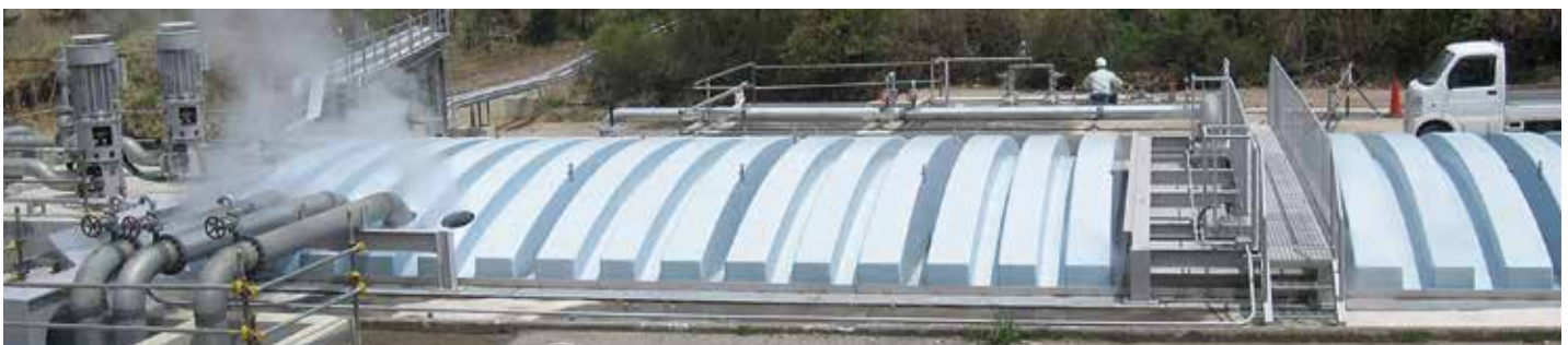
● 防蒸カバー(九州電力 大岳地熱発電所)
