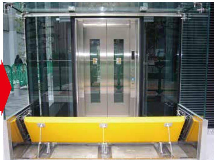
防水扉が自動的に立ち上がり、水の浸入を防ぎます。
